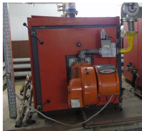
Figura 8.7 – Sistema di generazione obsoleto da sostituire
