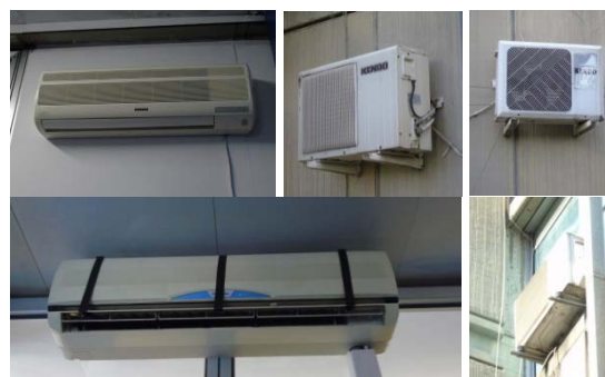
Figura 4.14 – Particolare delle pompe di calore monosplit (unità interne ed esterne).
